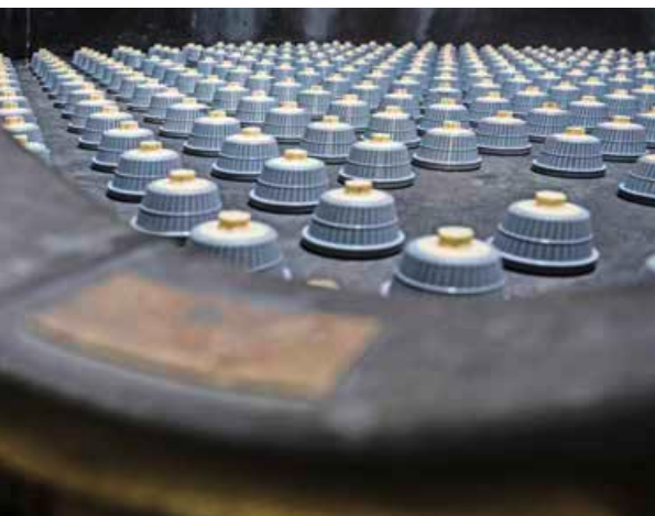
Wenn die Filteranlage gerade nicht mit Sand gefüllt ist, sind die Düsen am Boden zu sehen
